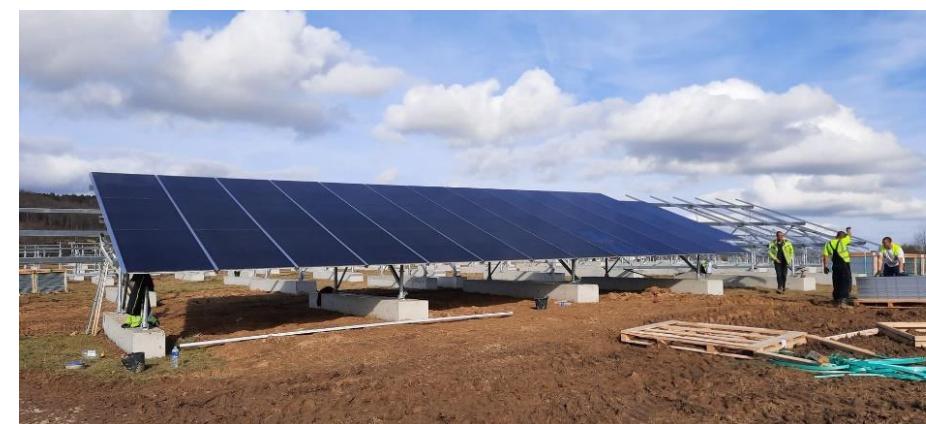
Exemples de mise en place de panneaux sur les chantiers URBASOLAR de Clarac (31) (source : Urba 312)
