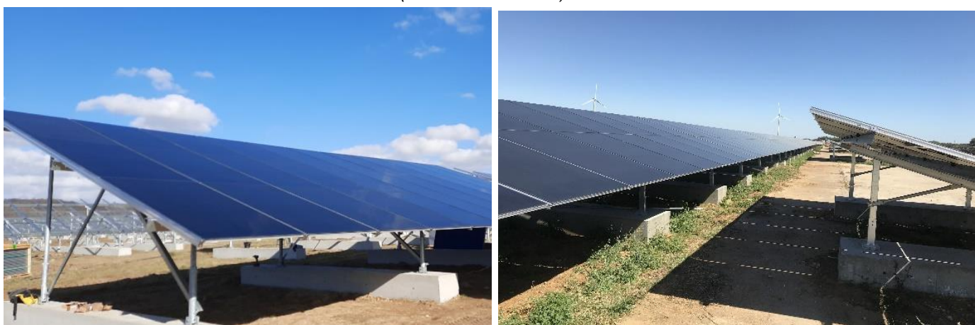
Illustration 6 : Exemples de réalisations Urbasolar : Clarac (31) et Saint Léger de Montbrun (79) (source : Urbasolar)
